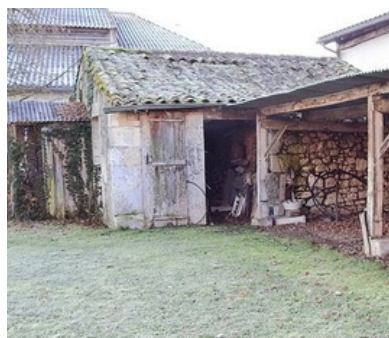
Dans le jardin des Maisons Brugère, four à pain bâti dans ce petit bâtiment. Ouvrage à réhabiliter.
