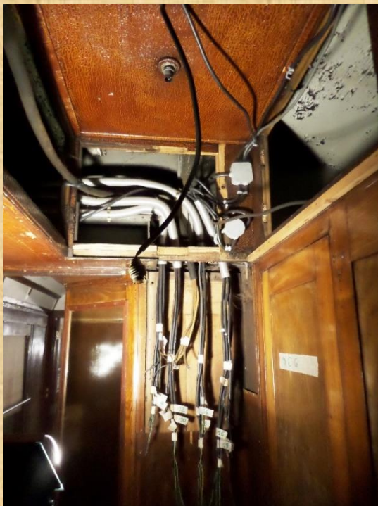
Document n°31 : Vue sur l'ancien tableau électrique
